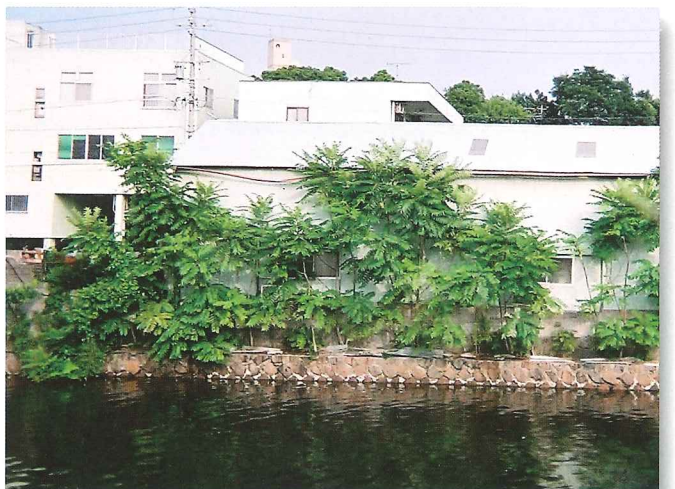
護岸も古くなり、改修が必要となりはじめている
